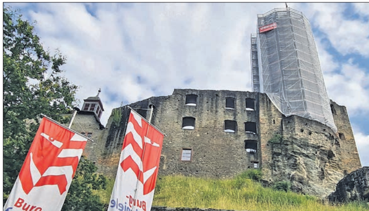
Blick zum Eppsteiner Bergfried von der Wooganlage aus. Die ausführliche Zusammenfassung der Schäden und Sanierungsempfehlungen stehen unter www.eppsteiner-zeitung.de an diesem Bericht. Foto: Stadt Eppstein
