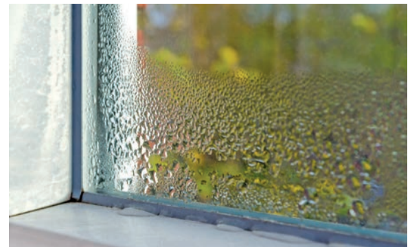
Feuchtigkeit in der Wohnung und als Ergebnis ein erhöhter Energiebedarf: Ein Austausch alter Dichtungsprofile ist dann oftmals unerlässlich.
