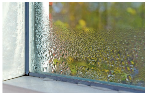
Feuchtigkeit in der Wohnung und als Ergebnis ein erhöhter Energiebedarf: Ein Austausch alter Dichtungsprofile ist dann oftmals unerlässlich. Foto: djd/GfA-Dichtungen/Getty Images/nadisa
