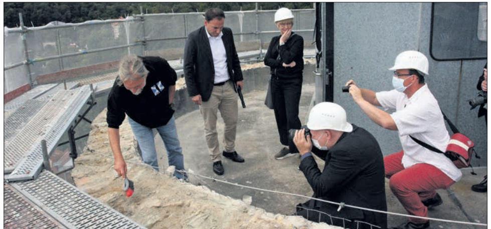
Die Mauerkrone der Turmplattform ist komplett feucht und muss abgedichtet werden, erläutert Joachim Zeune Bürgermeister Alexander Simon und Sabine Bergold (v.li.). Das Wetterhäuschen wird frühestens im nächsten Jahr ersetzt. Dazu ist das Gerüst nicht mehr notwendig.
