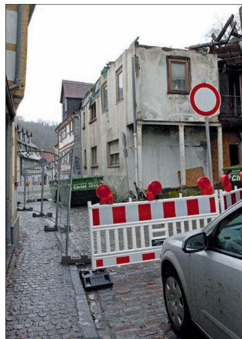
Abbruchreif: Das Haus in der Burgstraße 60.
