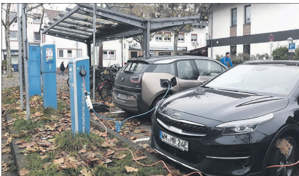
Die Ladestation am Rathausplatz wird gern genutzt – auch von auswärtigen Gästen. Foto js
