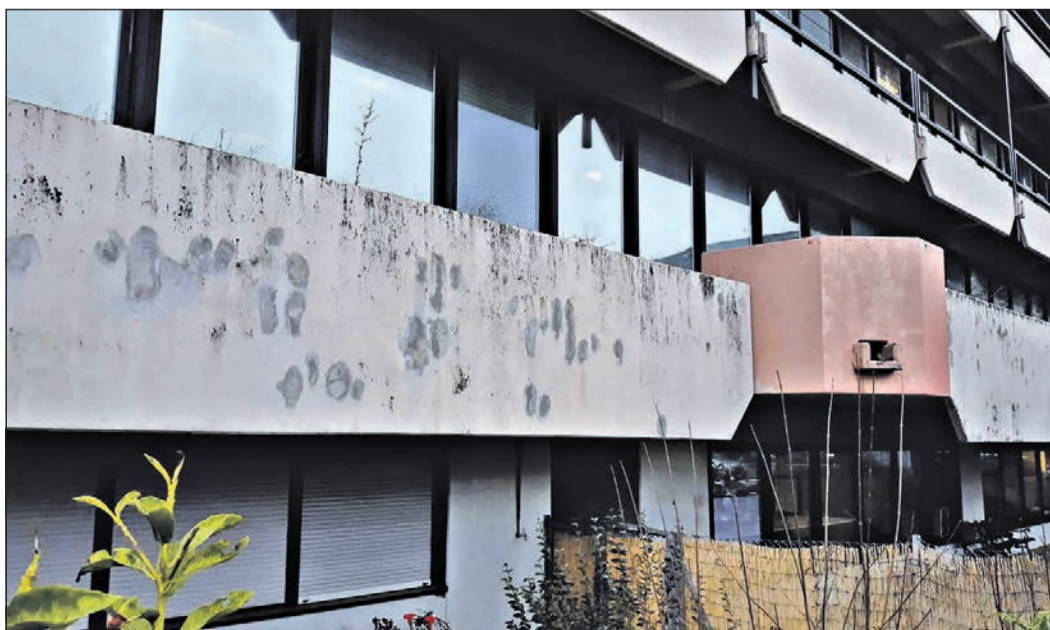
Die Fassade des Rathauses ist marode und nicht mehr tragfähig. Sie müsste komplett ersetzt werden bei einer Sanierung. Foto: js
