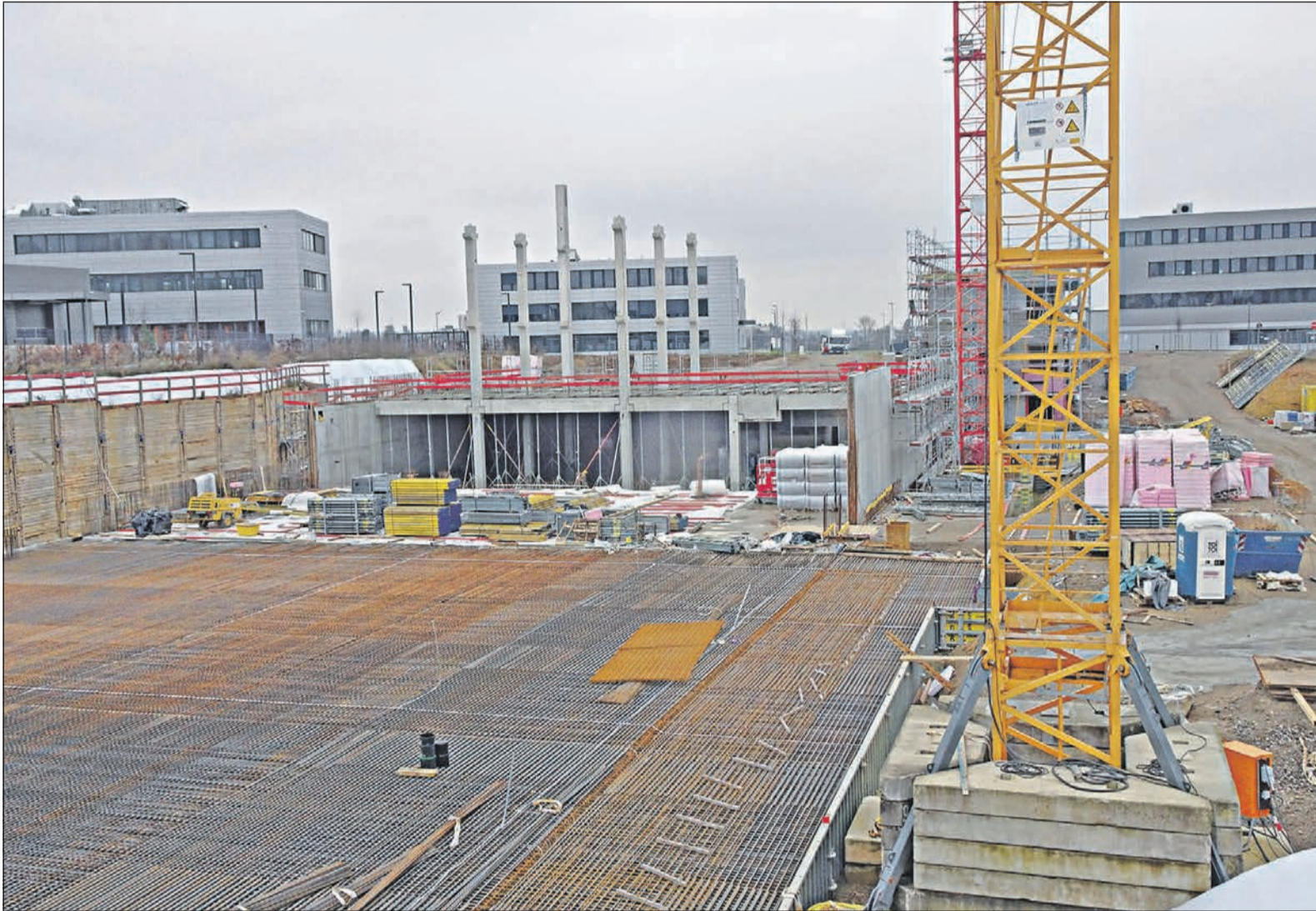
Im Vordergrund ist die Bodenplatte der Logistikhalle erkennbar, deren erster Abschnitt bereits in einem Jahr in Betrieb gehen soll. Im Hintergrund rechts ist der Wirtschaftsbau zu sehen. Foto: HB
