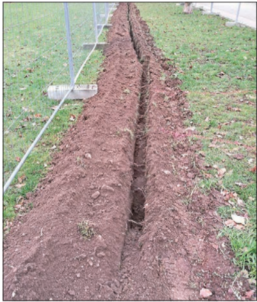
Nach der Verfüllung des schmalen Leitungsgabens wird vom Bewässerungssystem nichts mehr zu sehen sein. Foto: BSO
