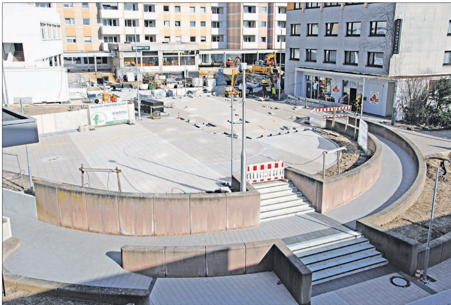
Die Bauarbeiten zur Umgestaltung des unteren Marktplatzes schreiten auch im März weiter voran: Das „neue Gesicht“ des Platzes ist schon gut zu erkennen. Foto: Stadt Schwalbach
