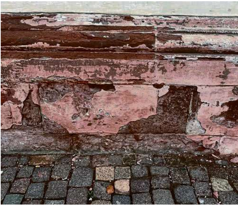
Fassade und Sockel von Schloss Philippsruhe haben schon bessere Tage gesehen. Wann es mit der geplanten Sanierung losgeht, steht noch nicht fest. FOTO: THOMAS SEIFERT
