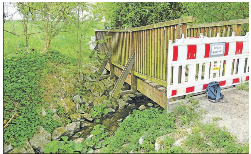
Die Schmetterlingsbrücke unterhalb des Teufelsberges ist baufällig und soll schon bald abgerissen werden. Foto: HB
