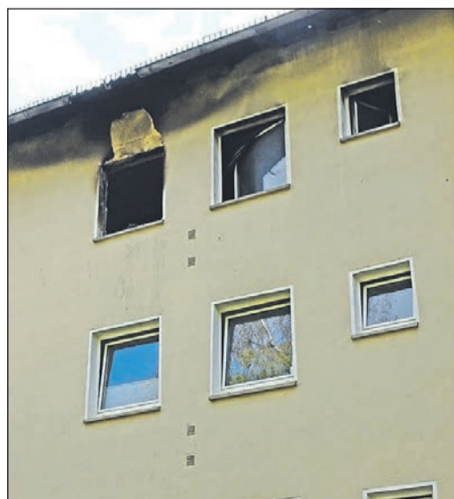
Rußflecken an der Fassade kennzeichnen die Wohnung, in der es am Mittwochmorgen vergangener Woche zu einem fatalen Feuer gekommen war. Foto:HB
