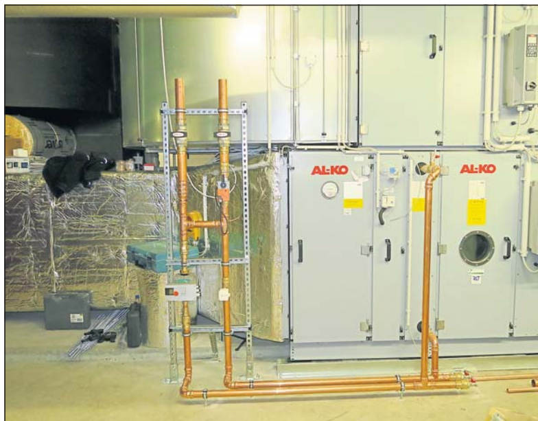
Die Lüftungsanlage im Keller...
