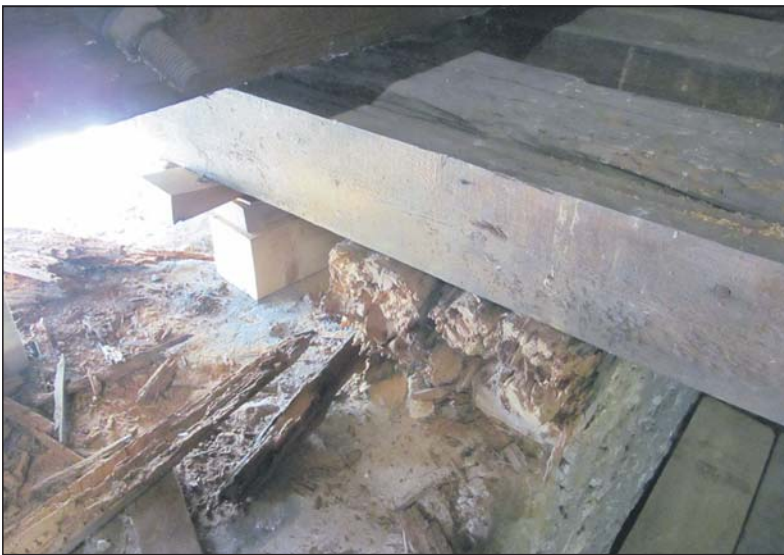
Schäden am Dachgebälk.
