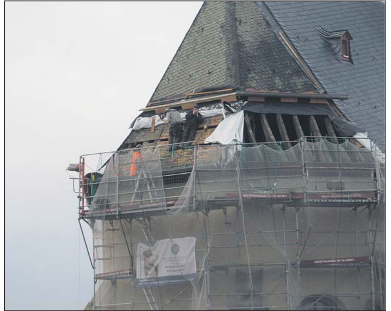
Offenes Dach der Pankratiuskirche.
