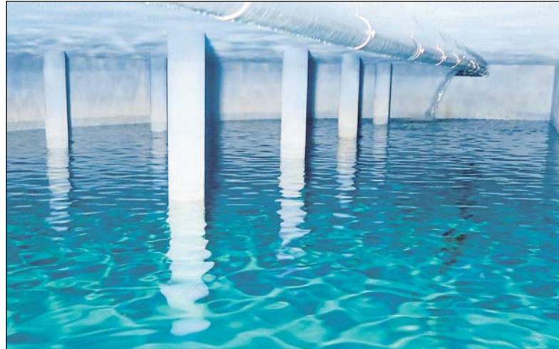
Linke Kammer des Hochbehälters der Gemeindewerke Budenheim – AöR am 31. Juli. Im oberen rechten Drittel des Bildes ist der Zulauf erkennbar.
