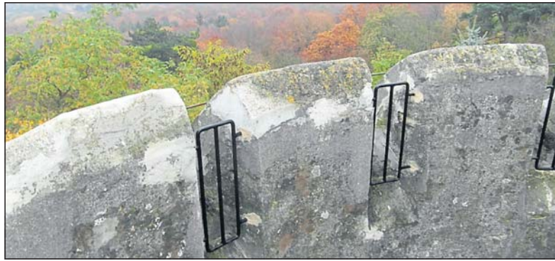
Die Mauerzinne auf dem Lennebergturnm vor der Sanierung.
