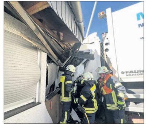
Das Müllauto beschädigte die Statik des Einfamilienhauses schwer. Foto: FFW Eppstein
