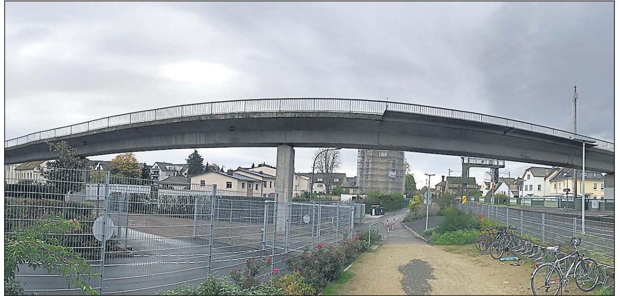
Die sanierungsbedürftige Anbindungsbrücke über die Bahnlinie.
