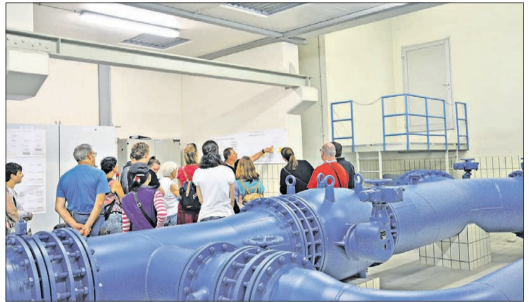
Interessiert folgen die Teilnehmer im Hochbehälter Borkenberg den Ausführungen von Henry Oestreich, Leiter des Technischen Betriebshofs der Stadtwerke. Foto: Jana Hartig
