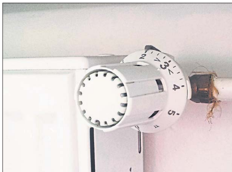
Thermostatventil auf Stufe zwei. (Foto: Verbraucherzentrale Rheinland-Pfalz e.V.)
