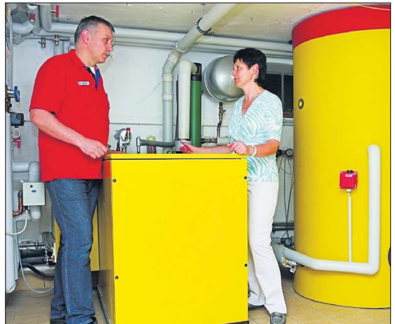
Heutige Blockheizkraftwerke haben nur noch Kühlschranksgröße. Sie werden meist mit Gas oder Öl betrieben.
