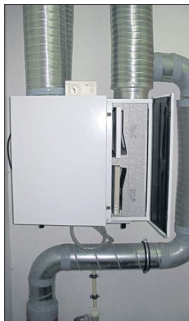
Lüftungsgerät mit zusätzlicher Wärmerückgewinnung.
