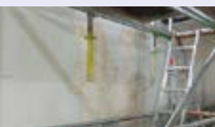
Stolzes Alter: Über die Jahre hinweg hatten sich Schäden gebildet.
