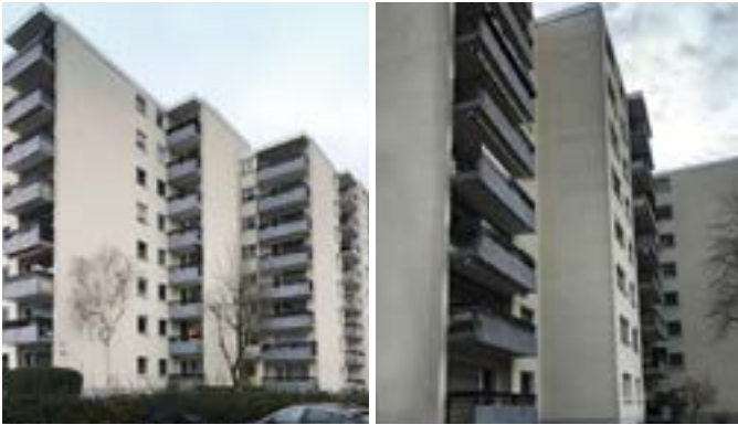
An der Fassade des Wohnkomplexes zeigen sich die Spuren der Zeit. Das Malerunternehmen Raab-Walz nimmt sich der Anlage an.
