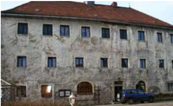
Leidet die Fassade, besteht akuter Handlungsbedarf, optisch und strukturell.
