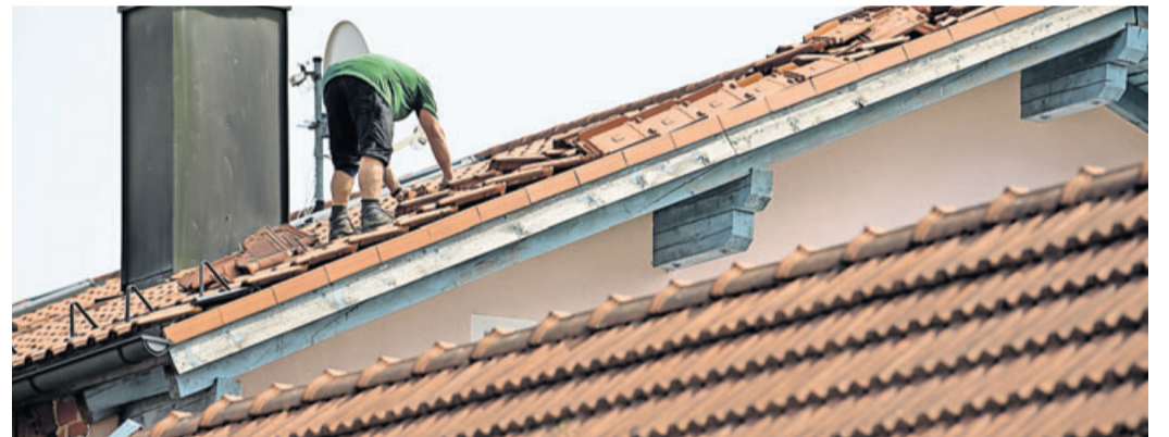
Hausbesitzer sollten das Dach prüfen - denn Stürme oder Gewitter können größere Schäden verursachen. Foto: Sven Hoppe/dpa/dpa-mag
