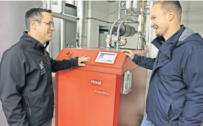
Klimaschutzmanager Markus Michel und Bürgermeister Eike See an einer Kraft-Wärme-Kopplungsanlagen in der Wetterauhalle.
