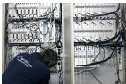
Aufbereitungssysteme für Breitbandsignale sind maßgeblich für höhere Bandbreiten im Netz.
