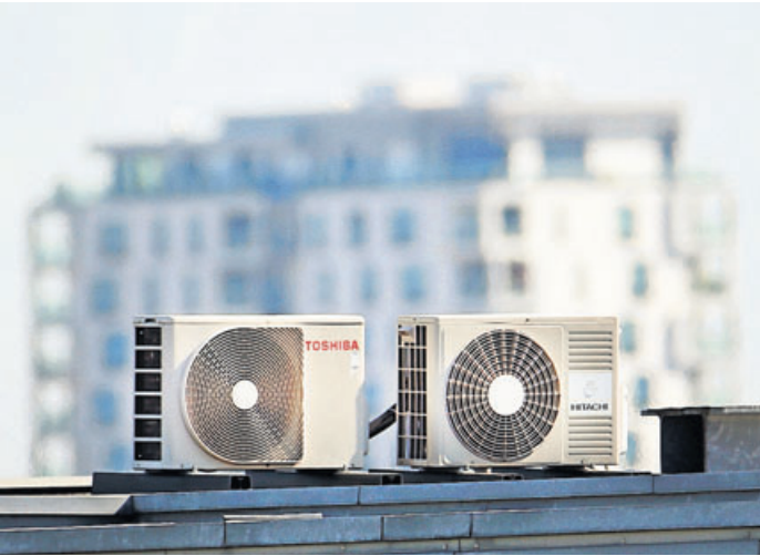
Eigentümer dürfen fest installierte Klimaanlage nicht einfach auf eigene Faust einbauen. Sie brauchen die Erlaubnis der Eigentümergemeinschaft. Foto: Martin Gerten/dpa/dpa-mag
