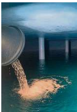
Ein Speicher im Wasserwerk in Erlensee-Rückingen der Kreiswerke Main-Kinzig.
