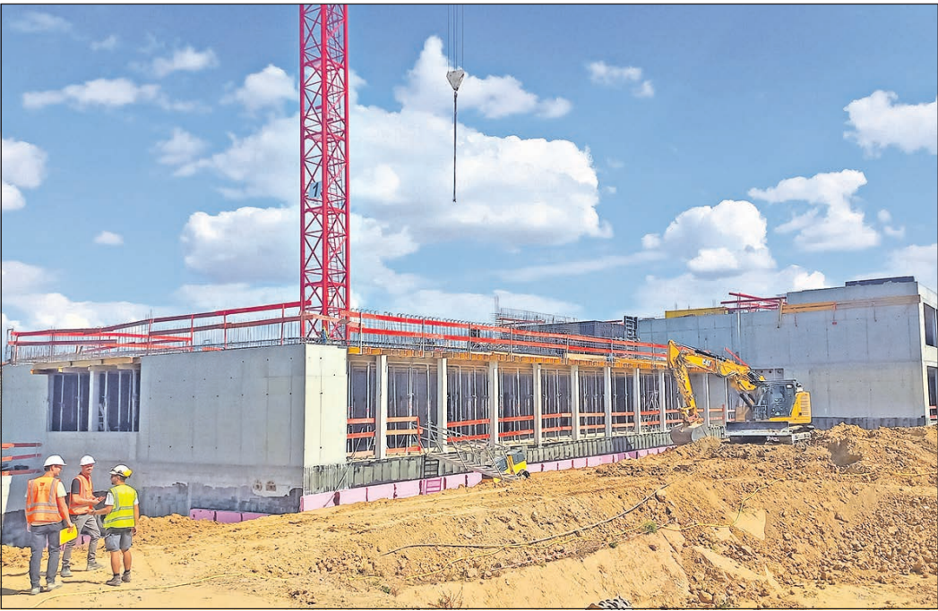
Das Vorzeigemodell der Zukunft, die neue IGS in Stierstadt: mit Eisspeicher, Wärmepumpen, Blockheizkraftwerk und Photovoltaikanlage. Foto: js
