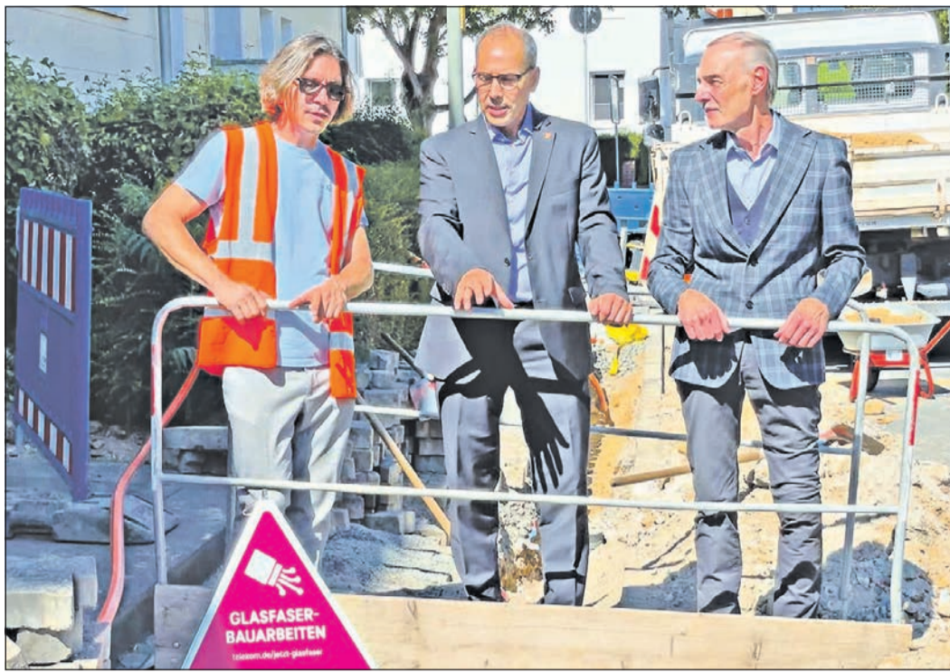
Hannes Meder-Werneck (WFH-Kabelbau), Bürgermeister Adnan Shaikh und Telekom-Region-Manager Hans Czorny begutachten eine Glasfaser-Baustelle am Stadtpfad (v.l.). Foto: Stadt
