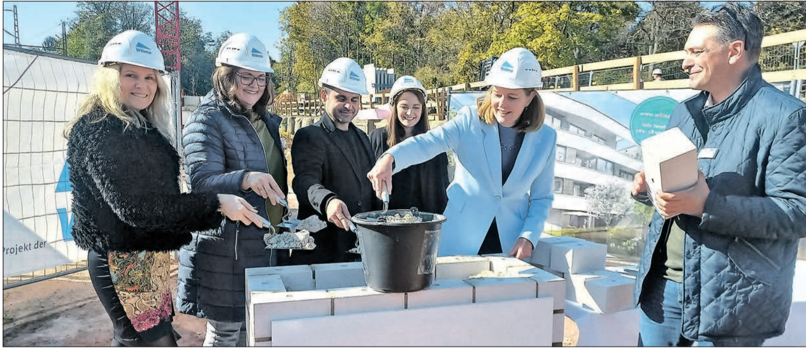
Gemeinsam für die Zukunft im Gleisdreieck: Den frischen Mörtel verteilen (v. l.) Karin Schunda, Projektleiterin Melanie Pürkner, Alexander Kaloudis und Alina Pauls vom Architektenteam, Bürgermeisterin Antje Runge und Wilma-Geschäftsführer Peter Wittel über der Zeitkapsel im Grundstein. Foto: js
