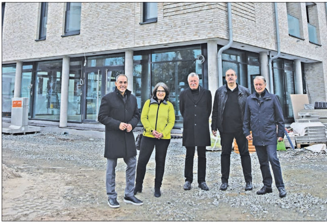
Bürgermeister Adnan Shaikh, Erste Stadträtin Bärbel Grade und Seniorendezernent Helmut Bauch (v. l.) machen sich gemeinsam mit der Geschäftsführung des Gemeinnützigen Wohnungsunternehmens Eschborn (GWE) ein Bild vom aktuellen Bautenstand der zukünftigen Seniorenimmobilie Eschborn. Foto: Stadt Eschborn
