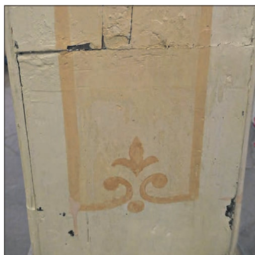
Das Holz an den Stützpfählen der Schlosskirche ist gerissen. Foto: a.ber
