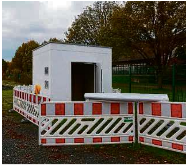
Der sogenannte Point of Presence steht neben der Mehrzweckhalle. Von hier aus sollen schnelle Bandbreiten auf die Haushalte verteilt werden.
