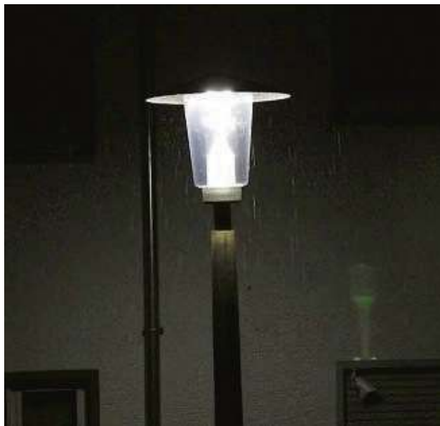
70 Prozent der Straßenlaternen in Maintal sind schon mit LED-Leuchten ausgestattet und leuchten daher wesentlich stromsparender als die Vorgänger. ARCHIVFOTO: JAN MAX GEPPERTH
