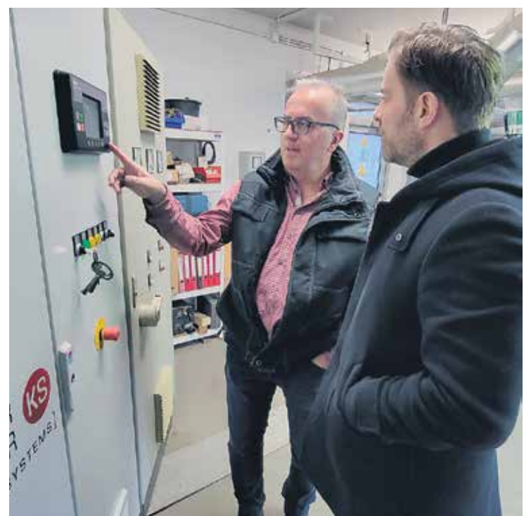
Holger Hahn (Abwasserverband Obere Aar) und Bürgermeister Sandro Zehner an der Schaltanlage des Blockheizkraftwerks.
