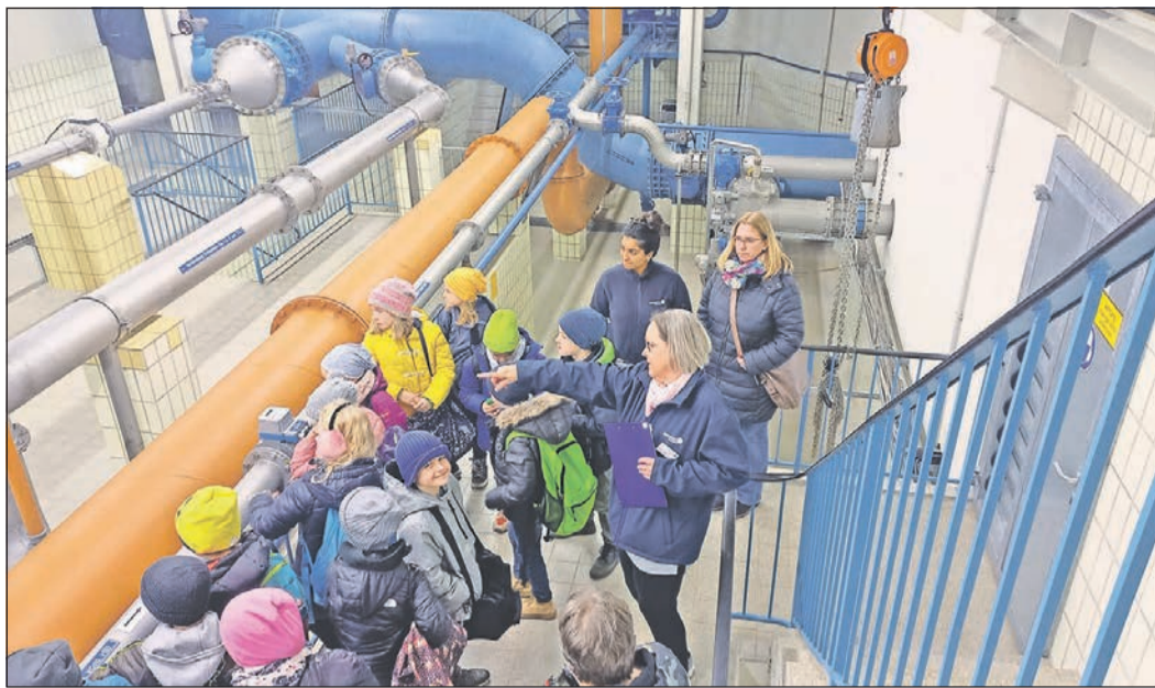
Über viele Treppen und zwischen dicken bunten Rohren hindurch führt der Weg zur Kathedrale des Wassers. Mit dabei auch Umweltingenieurin Arabi Yohageethan (unten l.). Foto: js
