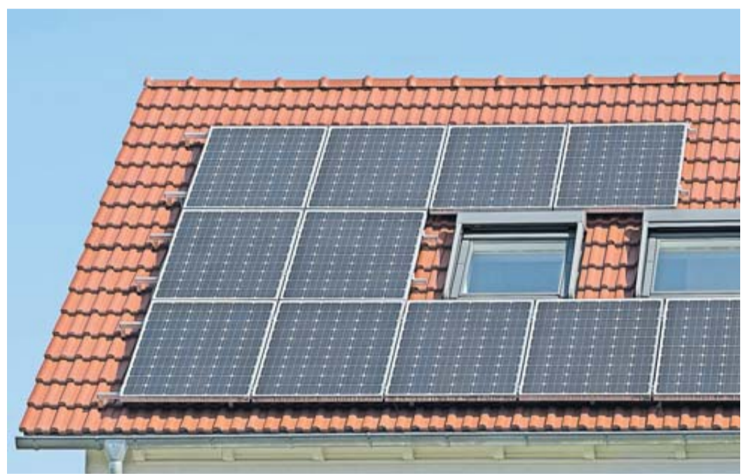
Dran gedacht? Von März bis September produzieren Solaranlagen rund 80 Prozent ihres Jahresertrags - daher sollte man jetzt ihre Funktionstüchtigkeit überprüfen. Foto: Uwe Anspach/dpa-mag
