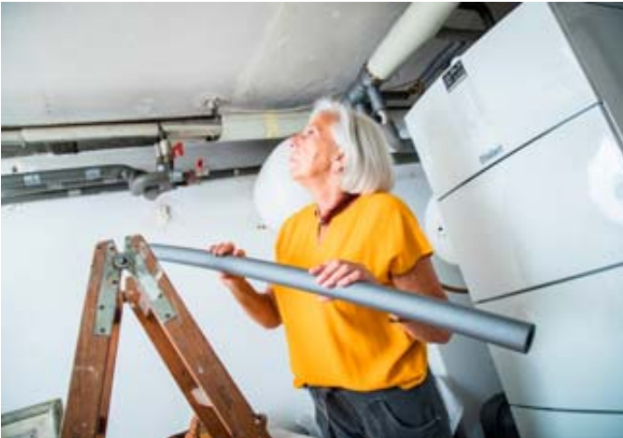
Die Dämmung von Heizungsrohren- und Leitungen ist schon seit 2020 Pflicht. Wer dem noch nicht nachgekommen ist, sollte das nun nachholen - auch um weniger Heizenergie zu verschwenden. Foto: Christin Klose/dpa-mag
