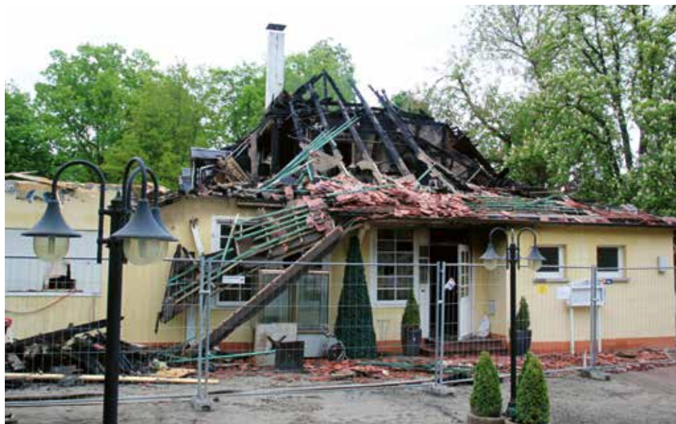
Bei einem Brand im Mai 2015 wurde die kleine Parkwirtschaft zerstört. Nun soll sie wieder aufgebaut werden.
