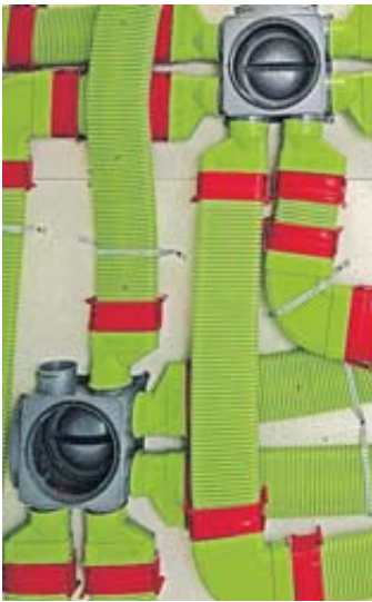
Eine Lüftungsanlage übernimmt den Luftaustausch im Haus.
