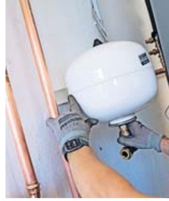
Kann sich lohnen: Der Einbau einer geförderten Heizung. Foto: Florian Schuh/dpa-mag
