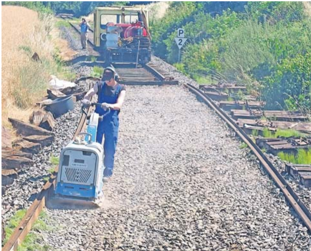
Arbeiten an der Bahnstrecke sind nicht nur zeitintensiv, sondern fordern auch viel Geld.
