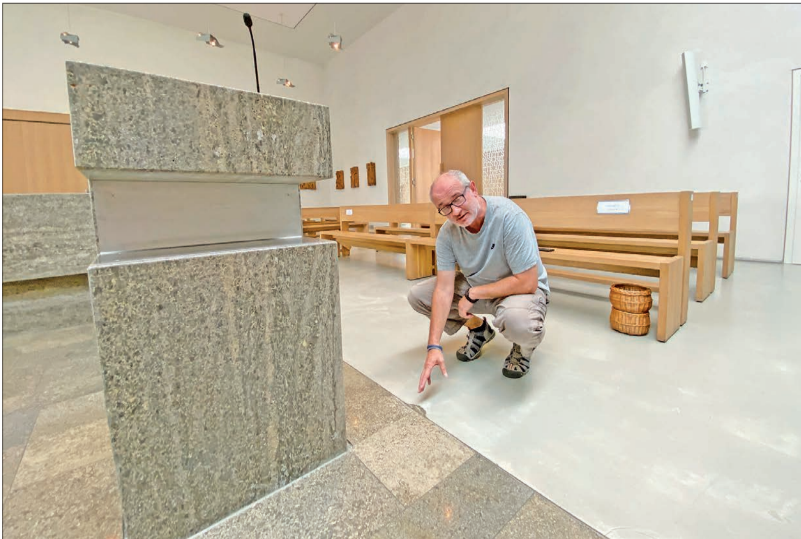
Pastoralrefrent Christoph Reusch zeigt den entstandenen Schaden am Übergang zwischen Altarbereich und Fußboden. Ebenfalls erkennbar sind die weißen Schlieren, die sich an der Oberfläche des grauen Bodens gebildet haben. Foto: csc
