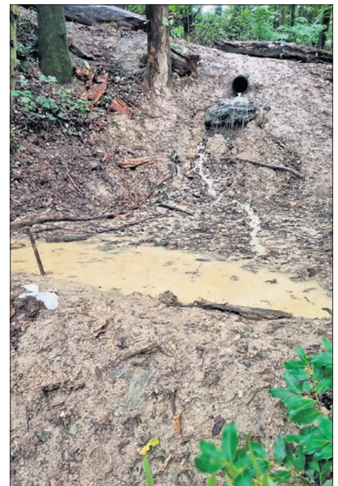
Die Mulde an der Böschung unterhalb des Niederjosbacher Sportplatzes dient dem Starkregenschutz. Foto: Stadt Eppstein
