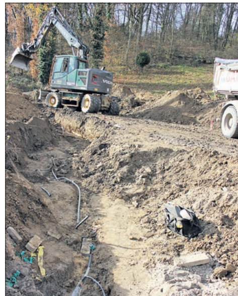
Bei den Erdarbeiten wurden Telefonkabel durchgetrennt. Foto: privat
