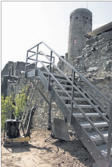
Mai: Die Sanierung des Burgturms ist abgeschlossen, am Wetterhaus wurden neue Hinweistafeln installiert. Danach wurde die neue Treppe zum Dach des Mainzer Kellers angebracht – rechtzeitig vor Beginn der Burgfestspiele. Foto: EZ
