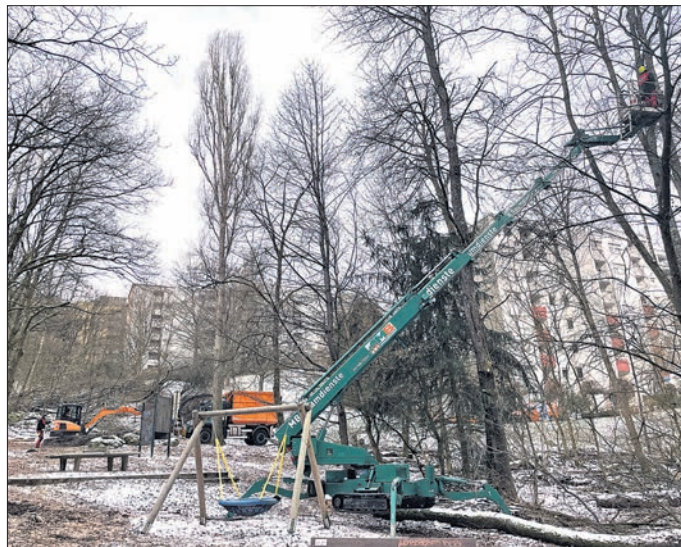
Aufräumarbeiten auf dem Spielplatz im Königsbachtal.
