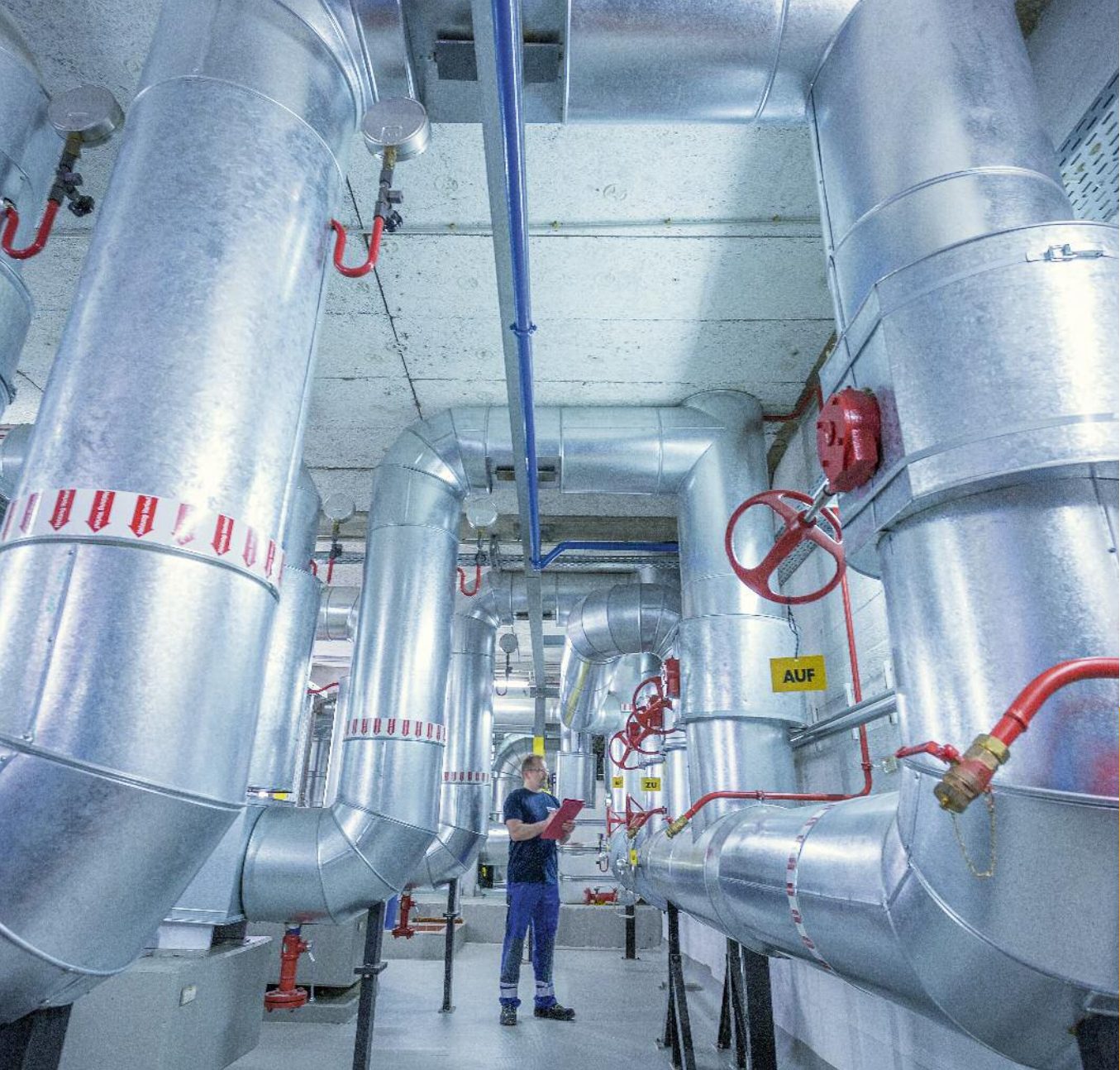
Das Heizkraftwerk im Europaviertel versorgt schon seit vielen Jahren mit klimafreundlicher Fernwärme.
