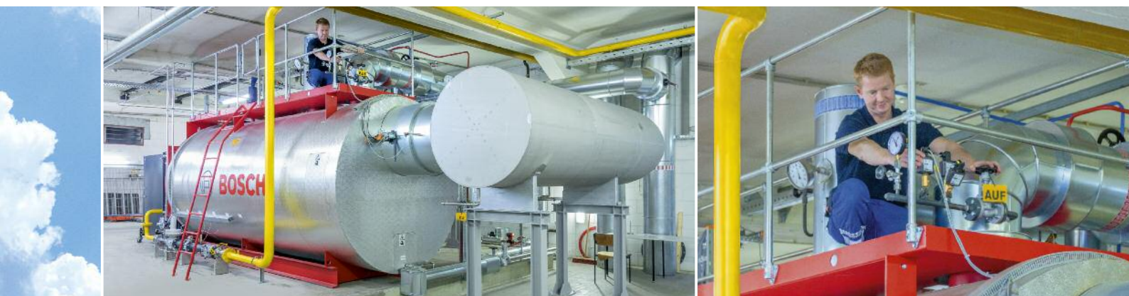
Der 6,5-MW-Kessel im Heizwerk Europaviertel ist einer von vier Kesselanlagen zur Fernwärmeerzeugung.
