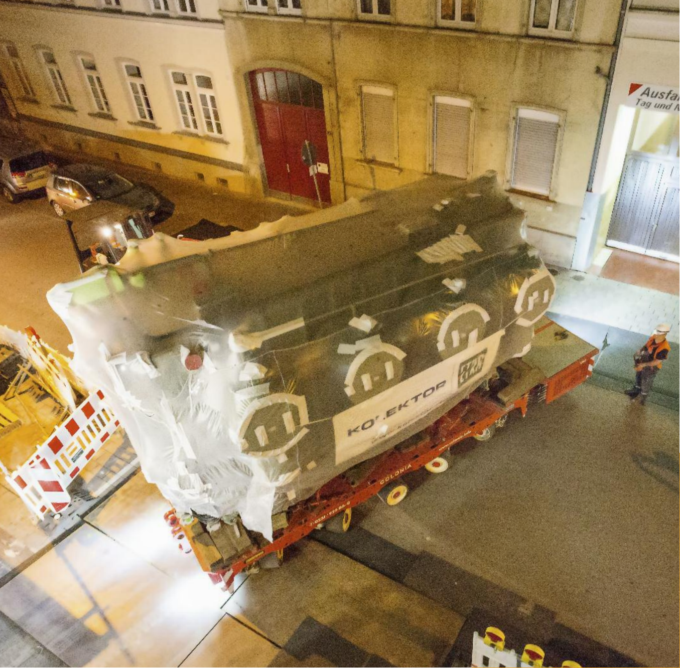
Das Umspannwerk in der Helene- straße, im Wiesbadener Westend, bekam einen neuen Transformator.
