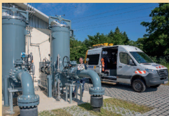
Gasübergabestation an der neuen Gashochdruckleitung.
