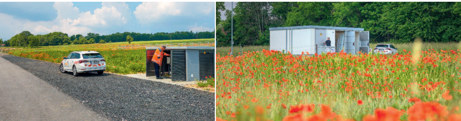
Zwei neue Netzstationen tragen zur Versorgung von 400 neuen Wohneinheiten des neuen Baugebietes in Bierstadt-Nord mit Strom bei.
