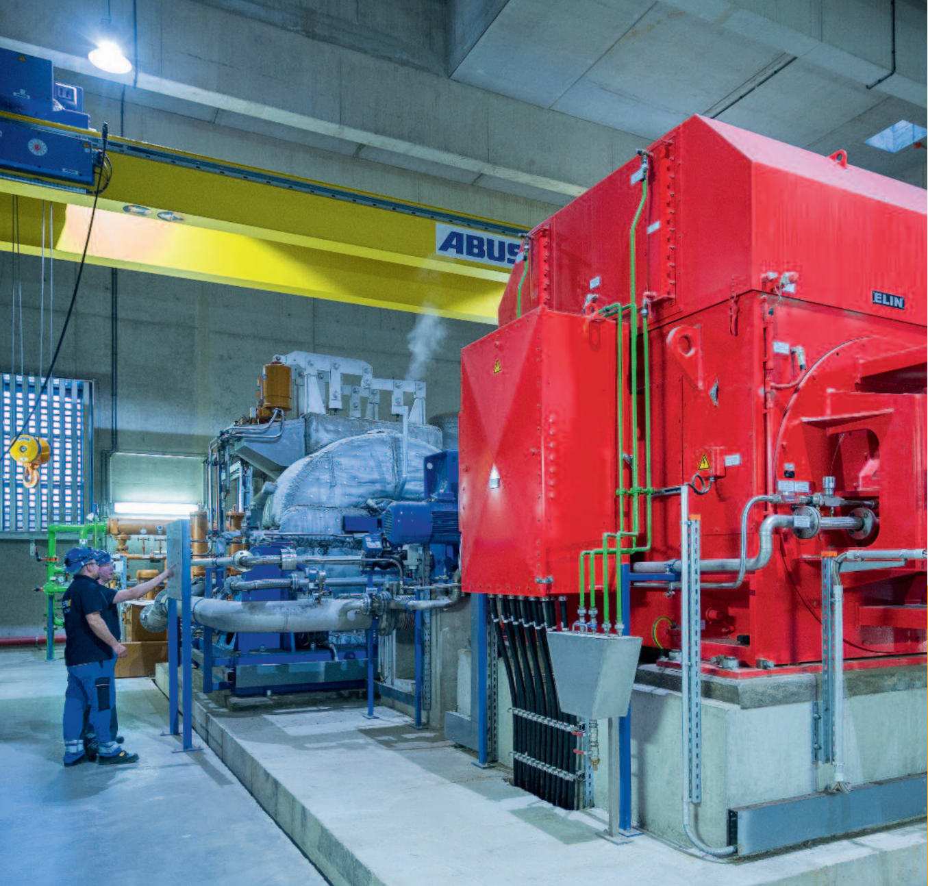
Das Biomasse Heizkraftwerk liefert einen wichtigen Beitrag zur umweltfreundlichen Energieversorgung von Wiesbaden mit Fernwärme.
