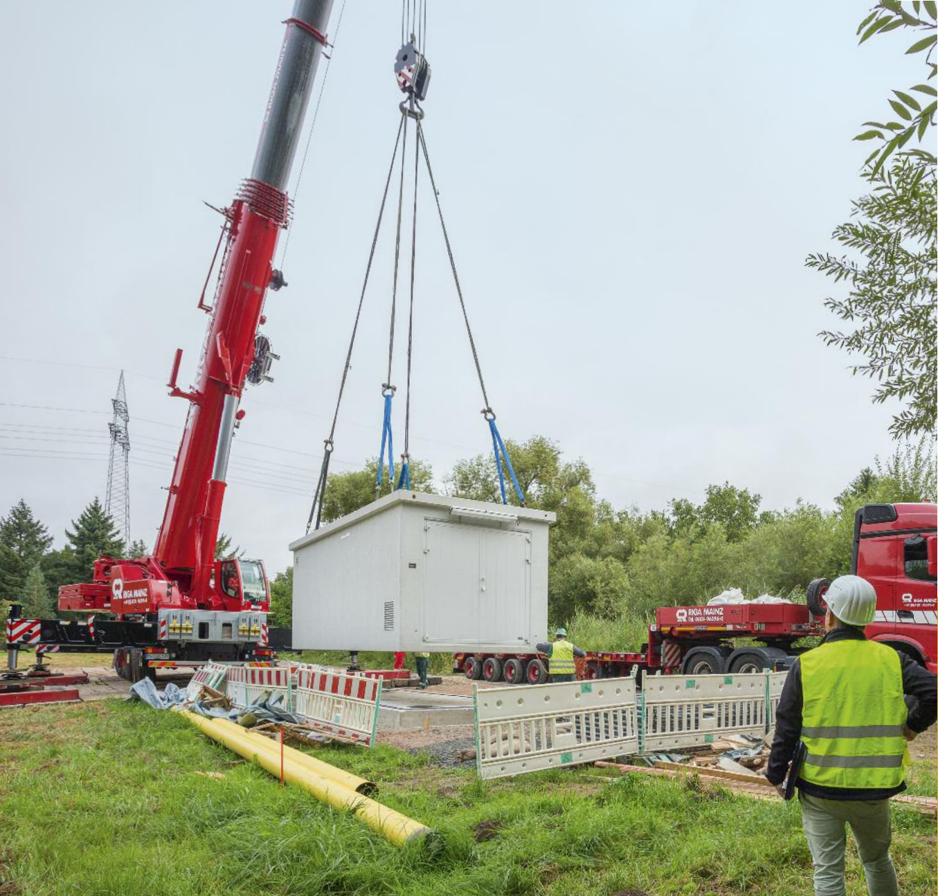
Erneuerung Gasdruckregelstation „Grunfelsbörnchen“, die den Gas- druck für die Orte Schierstein, Frauenstein, Bärstadt, Hausen und Georgenborn regelt.
